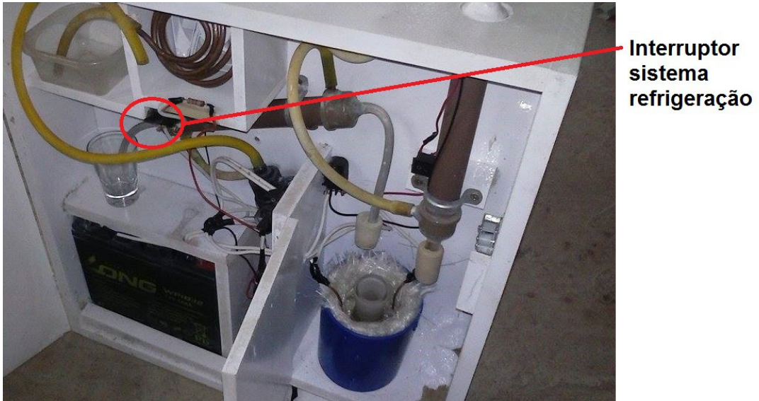
Figura 16. Posição do interruptor do sistema de refrigeração.
