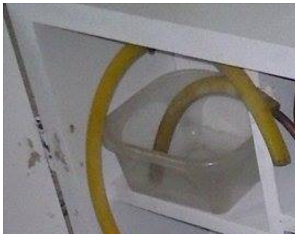
Figura 13. Reservatório de água do radiador do sistema.
