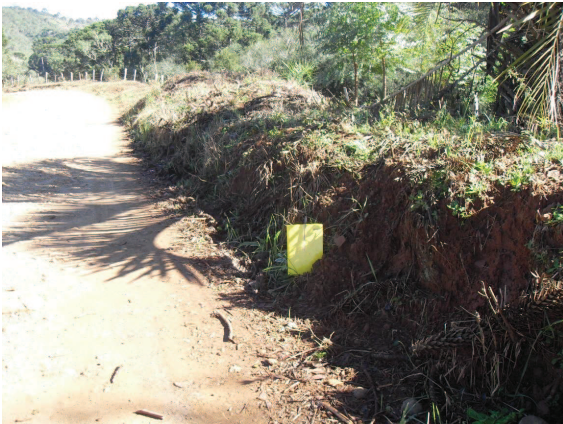
Figura 3: Barranco formado pelo rebaixamento do leito da estrada principal ocasionada por práticas de manutenções que visam à raspagem do leito da estrada e a retirada de material da mesma (bota fora). Data: 05/06/2013.
