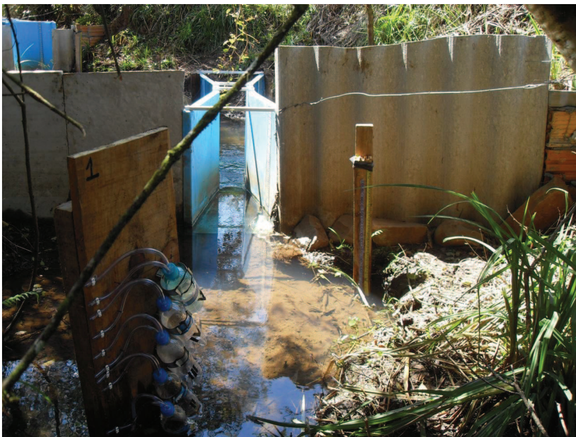
Figura 7: Equipamentos instalados no ponto 1, A esquerda o Amostrador de Nível Ascendente, mais ao fundo a direita a Régua Fluviométrica de Máxima Vazão e ao fundo a Calha Parshall. Data: 23/08/2012.
