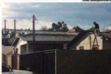
No Conradinho, várias casas foram destelhadas pela tempestade. No fim da chuva, várias pessoas consertavam as coberturas
