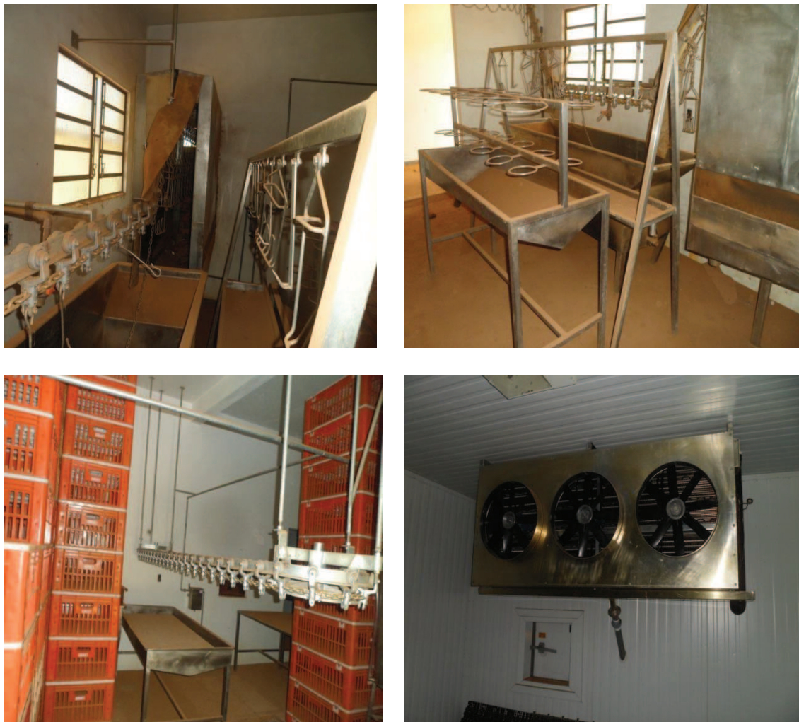
Figura 12: Equipamentos abandonados (abatedouro, depenadeiras, máquina de corte de vísceras e câmara fria).
