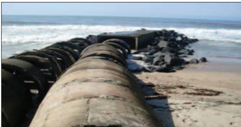
Figura 29: Canos de esgoto na Praia Central. Fonte: MACHADO, janeiro de 2012.
