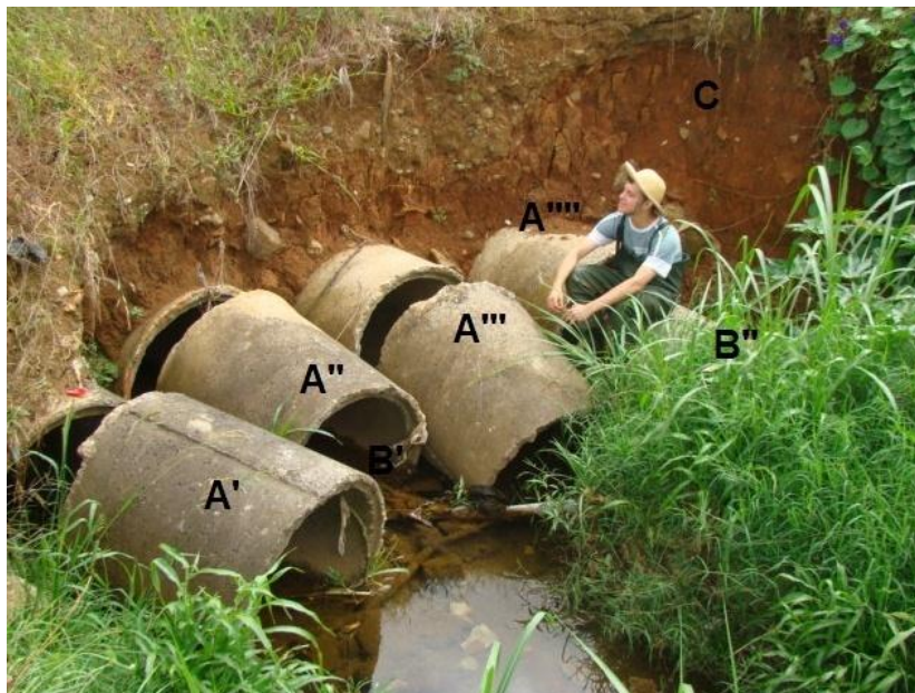
Figura 5.60 – Seções fechadas com entulho e alteradas pela desestabilização do solo
