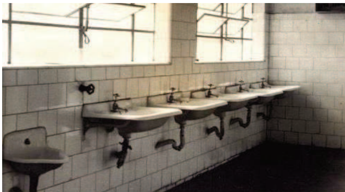
4.12 FIGURA 13 - Instalações sanitárias
