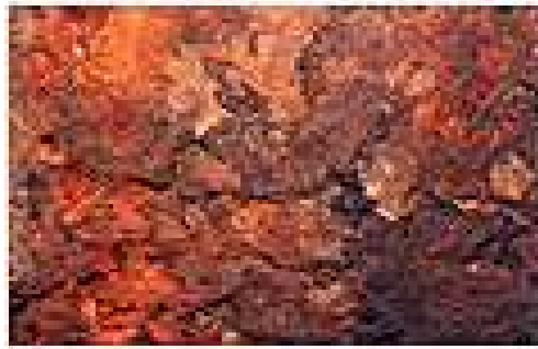
Figura 2: Corrosão uniforme generalizada
