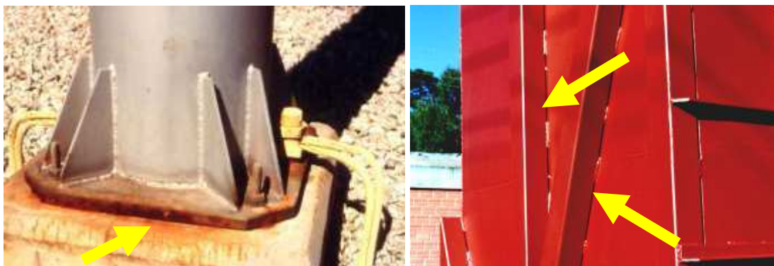
Figura 7: Corrosão por aeração diferencial em frestas
