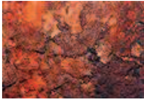
Figura 4. Corrosão uniforme e generalizada [63].
