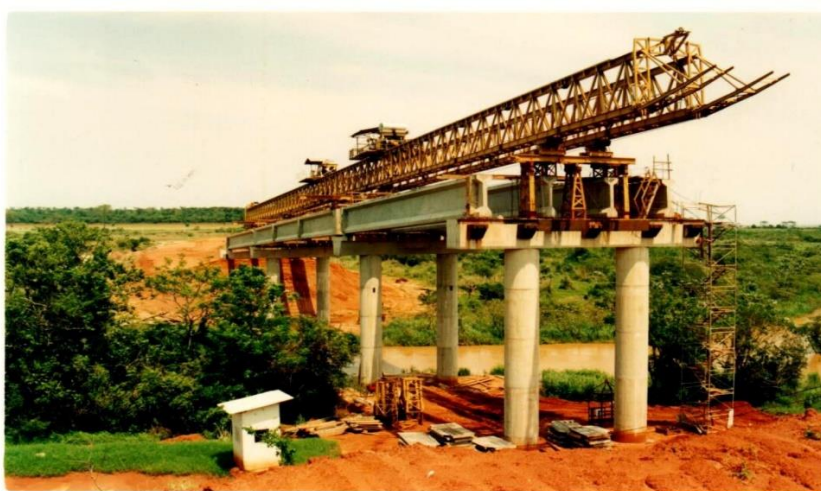
Imagem 15 – Ferragens da estrutura de uma ponte.
