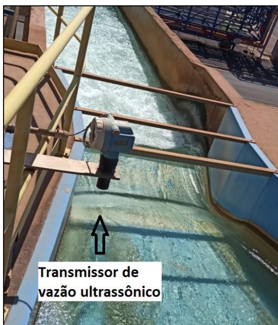
Figura 4.3: Medidor de vazão Calha Parshall e sensor medição vazão ultrassônico
