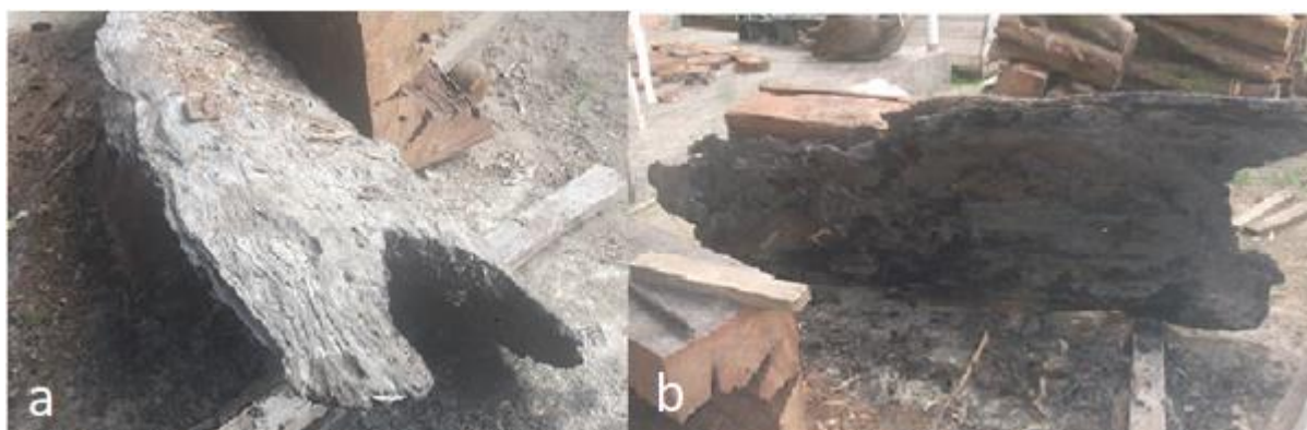
Figura 9: (a) Peça de Sucupira-preta com sinais de carbonização nas extremidades, (b) deterioração na parte inferior da peça (fonte: autor).
