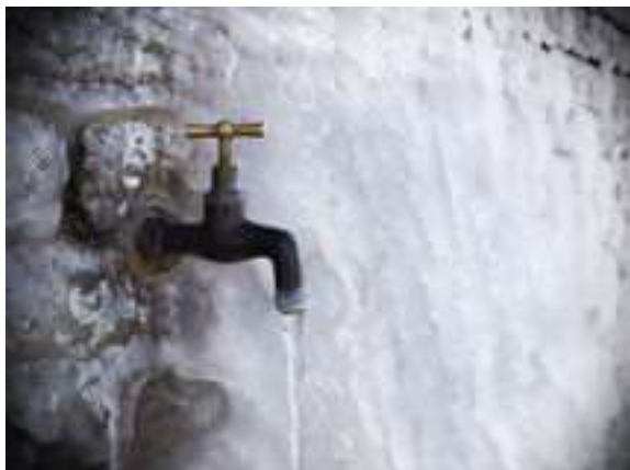
Figura 38: Torneira aberta para evitar congelamento na tubulação.
